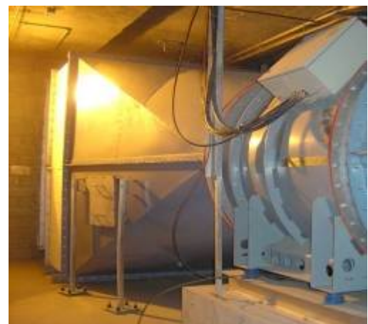
Fig 3.13: Tunnel Ventilation Fan
