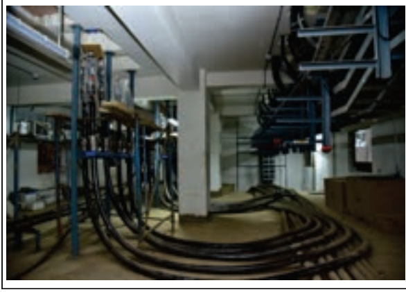
केबल तळघर खोली
